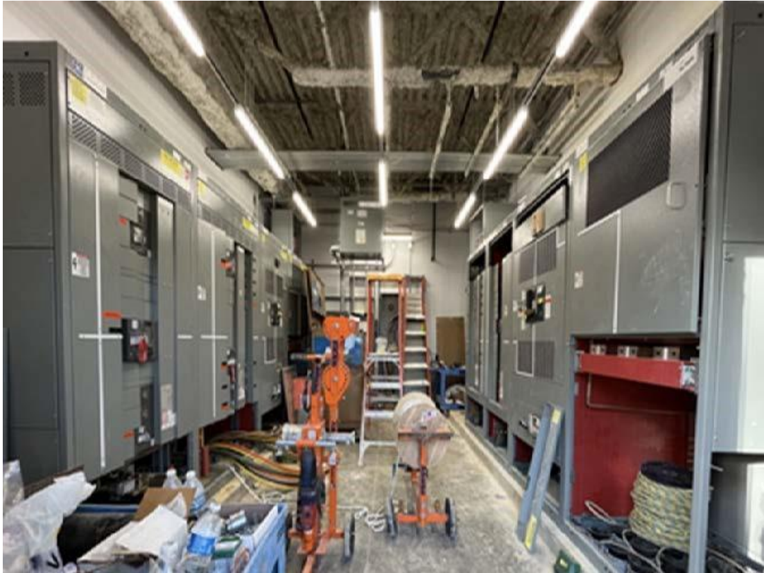
Sala eléctrica principal: tablero de distribución
