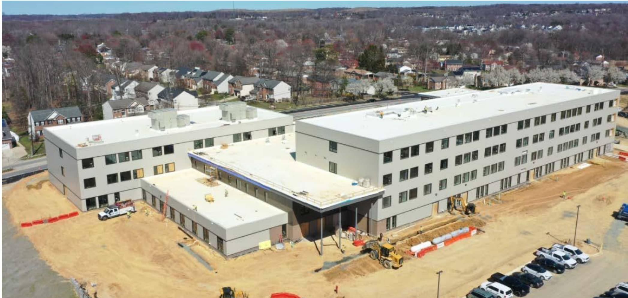
Vista aérea del costado de la entrada oeste del edificio a finales de marzo.
